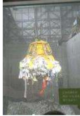
ごみピット+ごみクレーン
